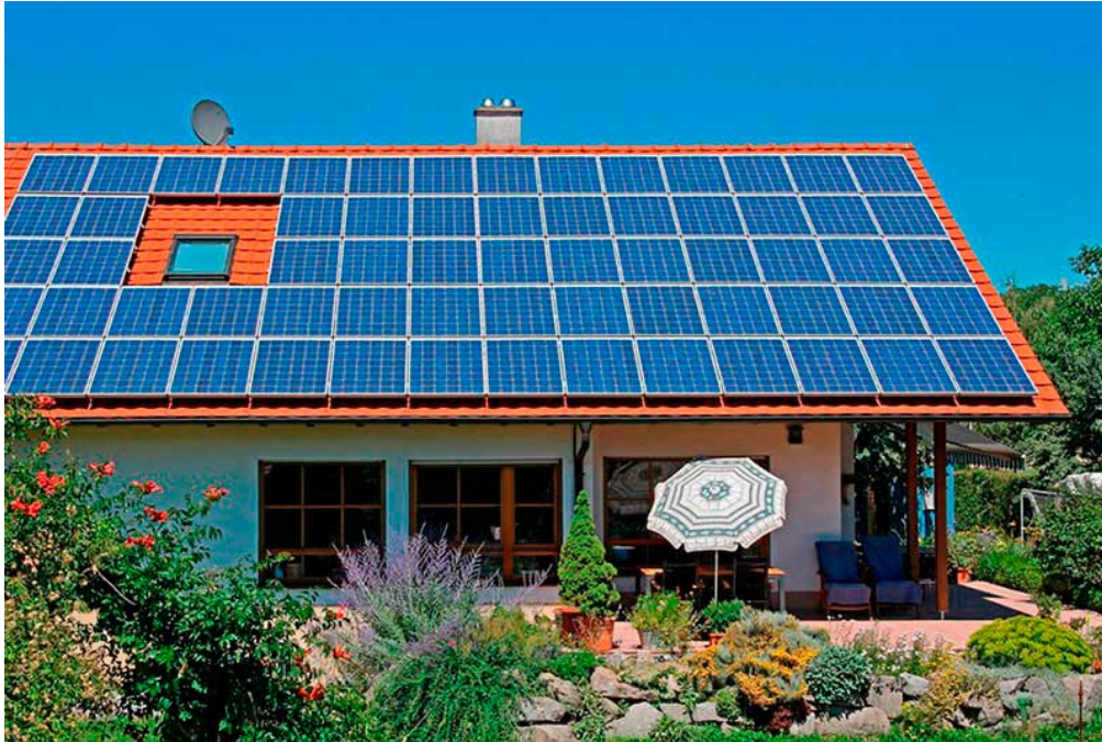
FIGURA 2.7 – Exemplo de micro-usina fotovoltaica.
