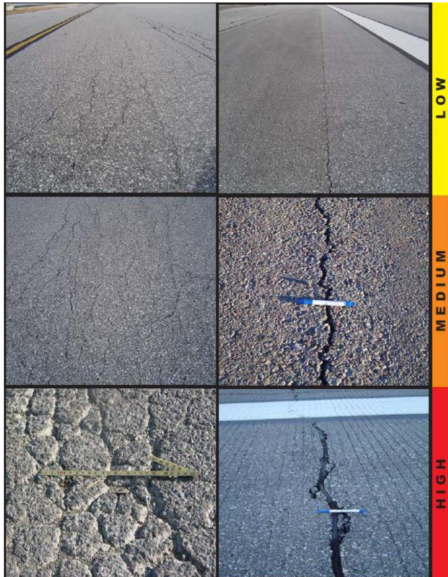
FIGURA 3: Trincas em pavimento flexível em diferentes graus de severidade. (SHAHIN, 2009).
