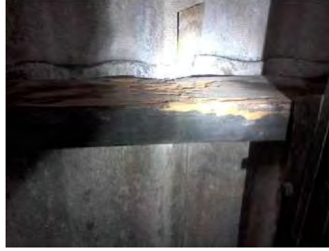
Figura 4.5 Estrutura deteriorada por cupim.
