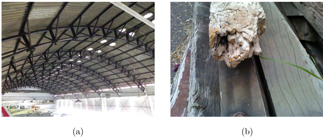
Figura 1.5 Estrutura do MUSAL: (a) cobertura; (b) tesoura atacada por cupim.
