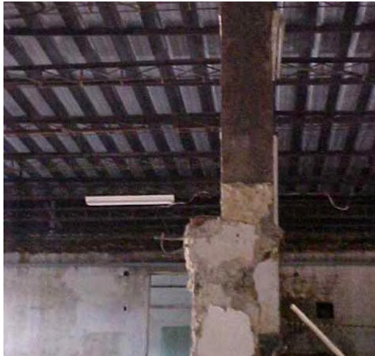
Figura 5. Pilar com grande excentricidade apoiado em alvenaria não estrutural
