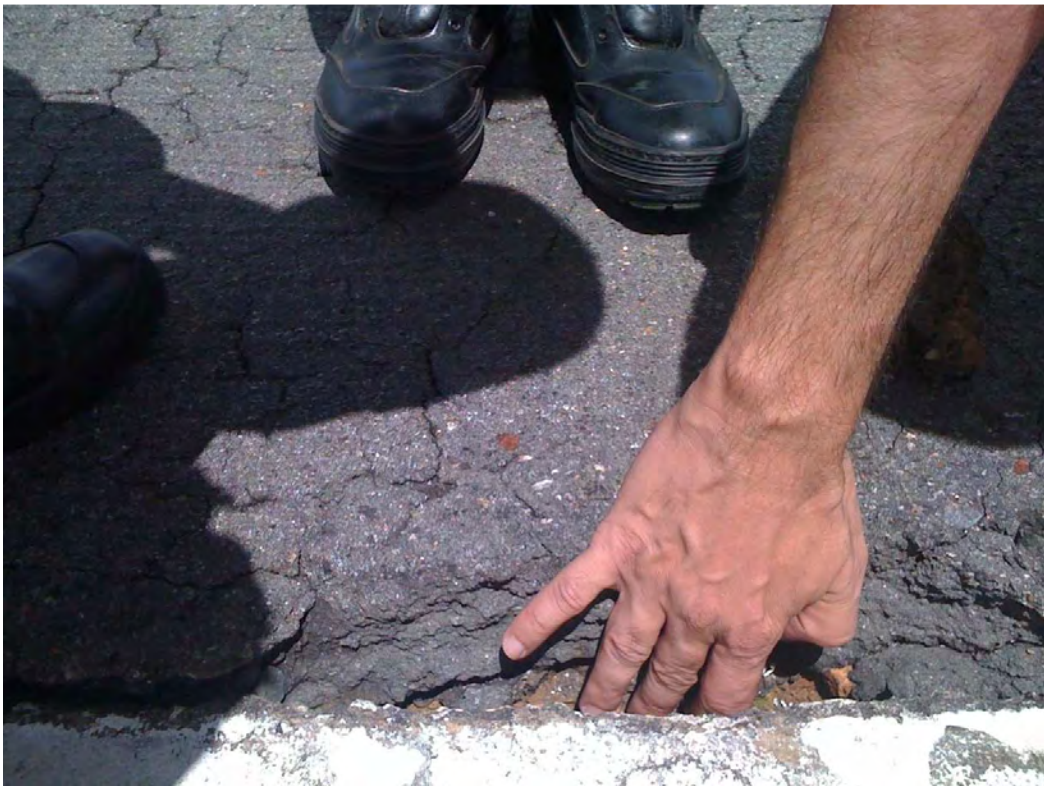
Figura 2 - Rachadura Larga na Cabeceira da Pista
