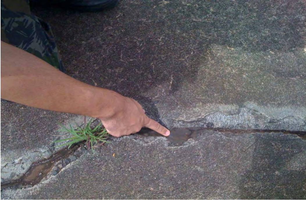
Figura 1 - Rachaduras nas Áreas de Espera
