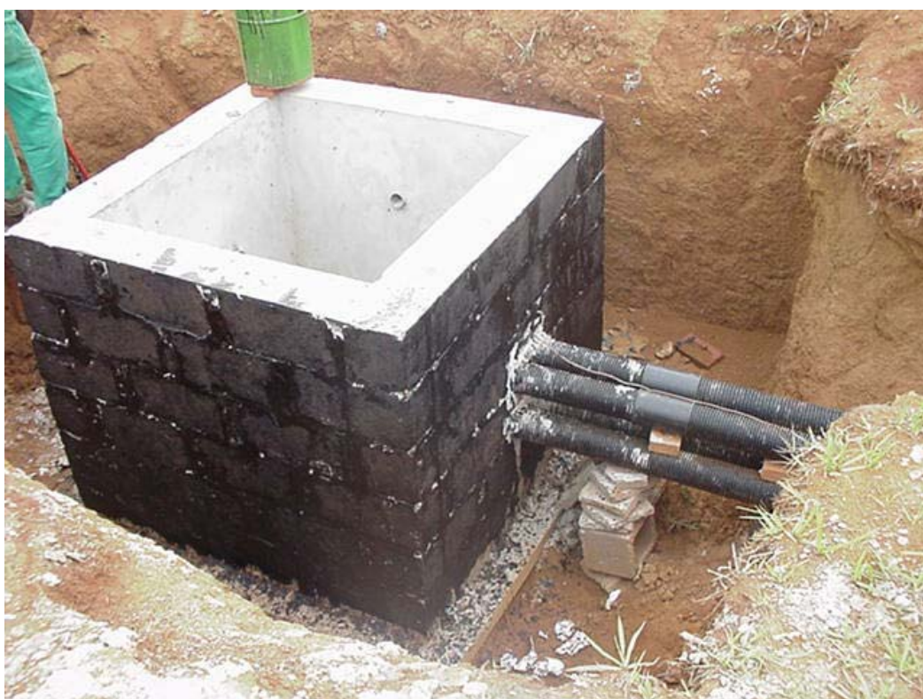
Figura 4: Caixa de Visita
