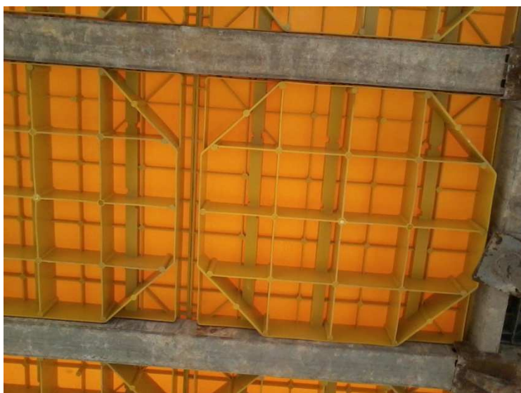
Figura 22 Interferência com escora durante a desfôrma.
