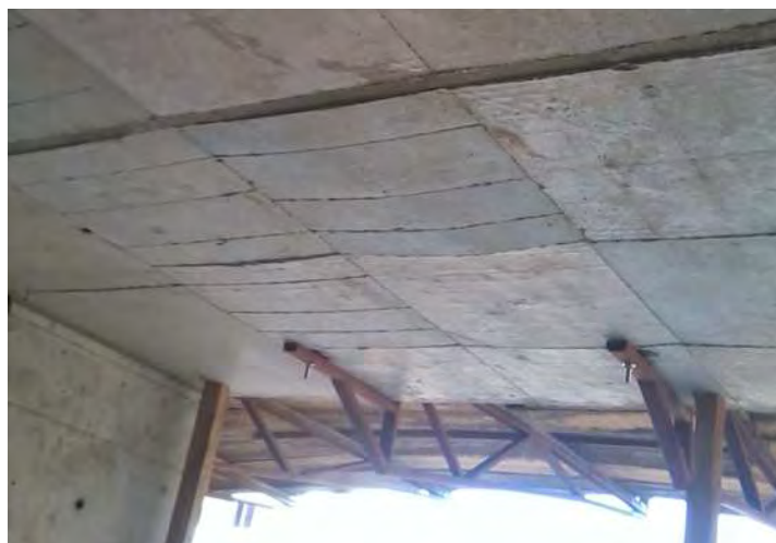
Figura 6 Flecha excessiva da laje (fonte: Impacto, 2014).
