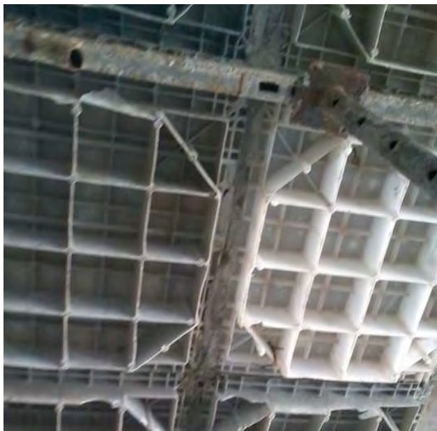
Figura 7 Vazamento de concreto entre as juntas do Plasterits (fonte: Impacto, 2014).
