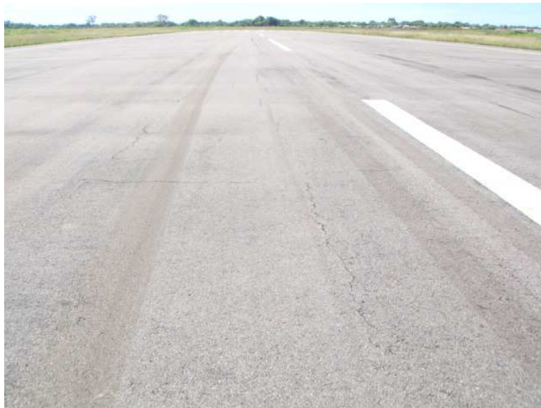
Figura 14. Foto do trecho de ampliação da pista de pouso de Eirunepé - AM
