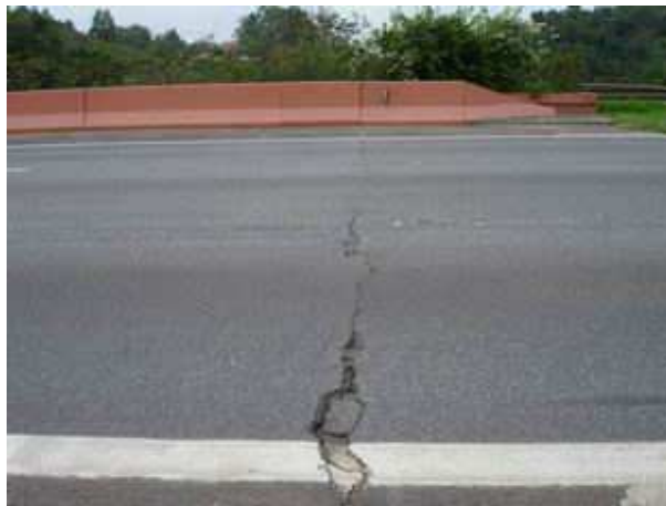
Figura 5. Foto de revestimento trincado
