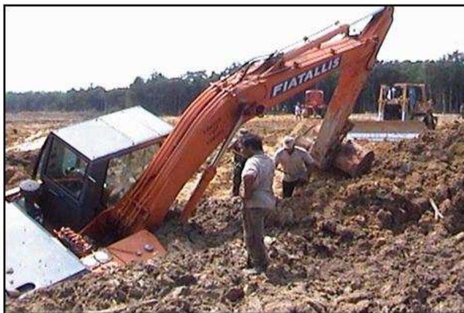
Figura 13 - Problemas enfrentados na obra durante época de chuva (AMARAL, 2009)
