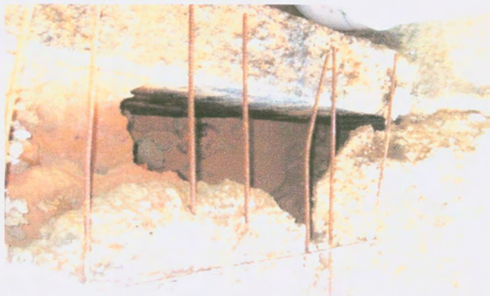
Figura 13 - Carreamento do material do solo sob o piso
