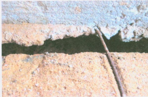
Figura 14 - Vazios sob o piso
