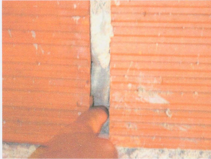
Figura 10 - Pouca argamassa entre os tijolos
