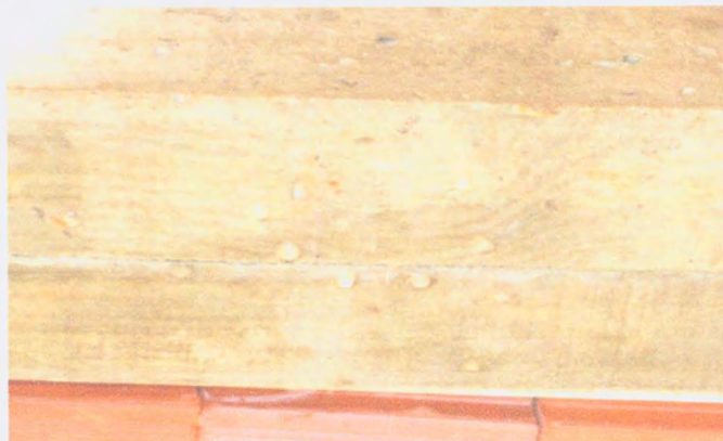
Figura 4 - Infiltração na união de vigas
