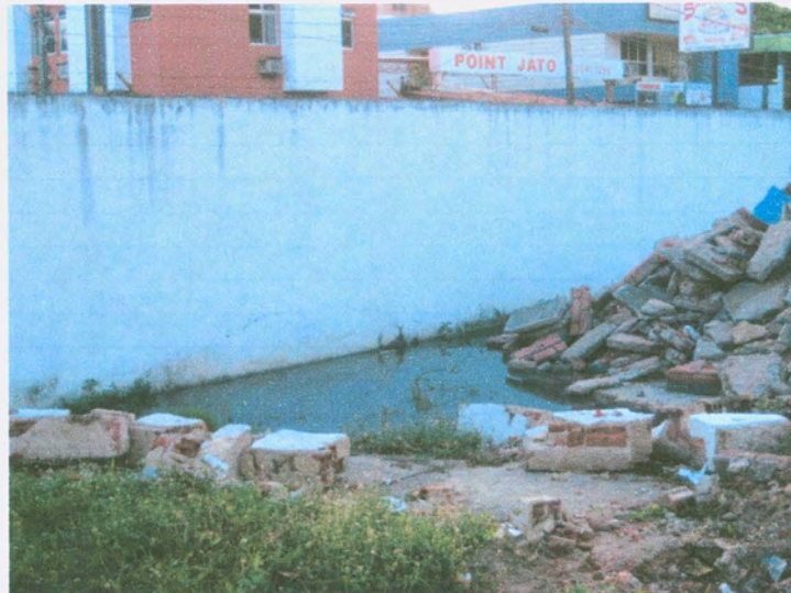
Figura 24 - Concentração de esgoto no ocal da obra
