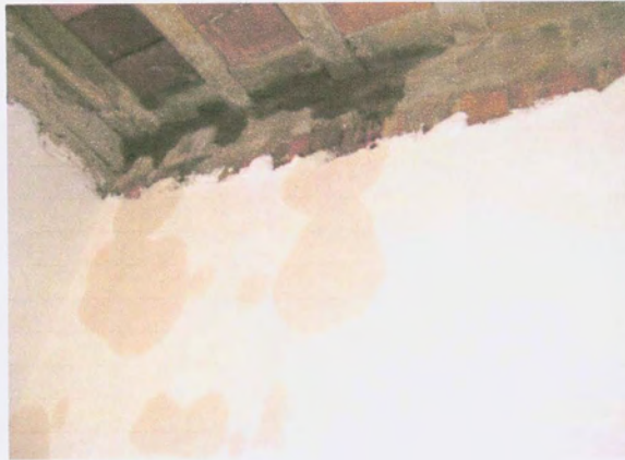
Figura 3 - Infiltração umedecendo o gesso do acabamento das paredes
