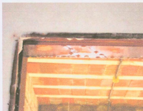
Figura 2 - Esquadria de porta encharcada por água da chuva
