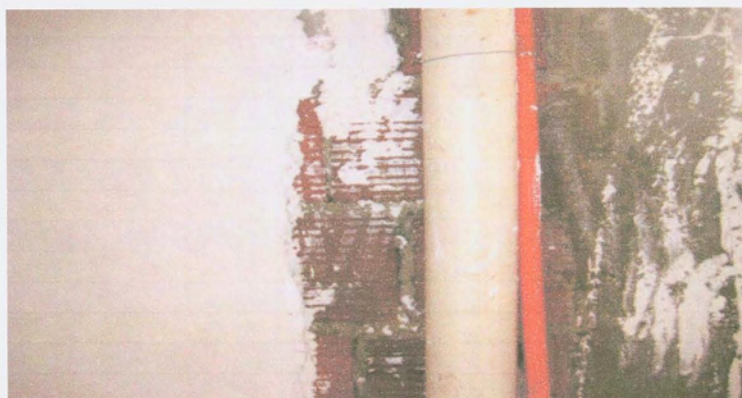
Figura 8 - Instalações elétricas unidas às instalações hidráulicas
