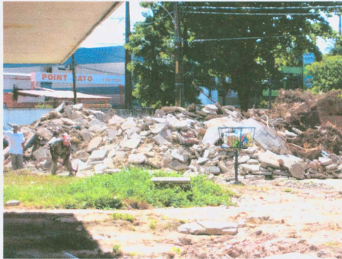
Figura 23 - Acúmulo de entulho e funcionários trabalhando sem EPI
