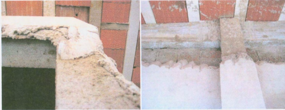
Figura 1 - Excesso de recobrimento de argamassa
