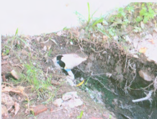
Figura 25 - Tubulação de esgoto rompida acidentalmente.
