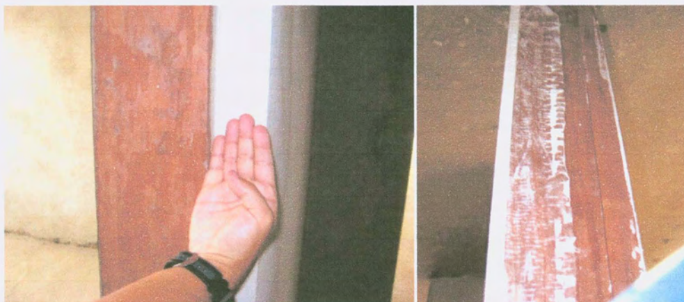
Figura 5 - Desajuste entre reboco e esquadrias das portas
