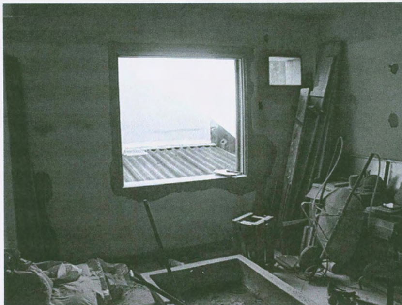
Fig 01- Aspecto dos apartamentos após retirada de portas e janelas, lixamento das paredes e posterior aplicação de argamassa para correção da superfície das paredes.
