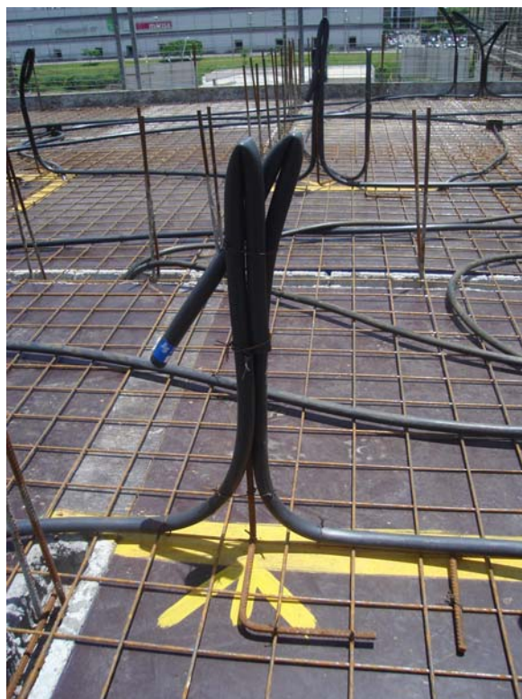
Figura 19: Detalhe do cabo de aço usado para sustentação da tubulação vertical.
