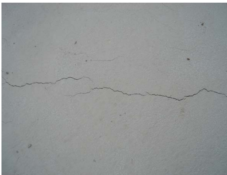
Figura 42: Detalhe de uma das trincas aparentes.
