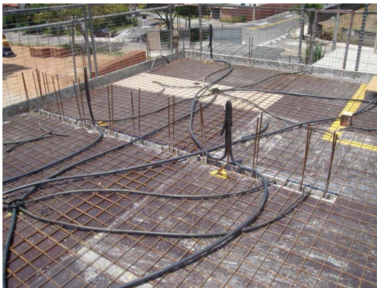
Figura 18: Detalhe das tubulações verticais.
