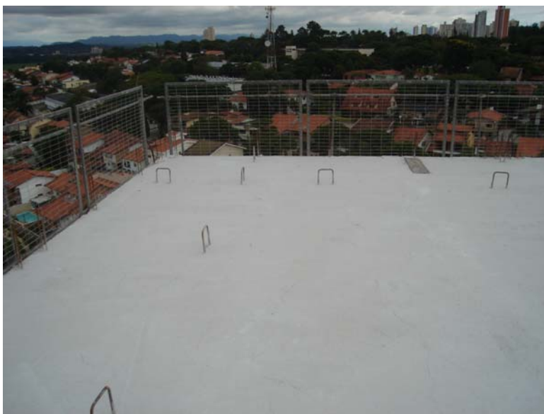
Figura 15: Pontos de apoio para o “balancinho” (andaime suspenso).
