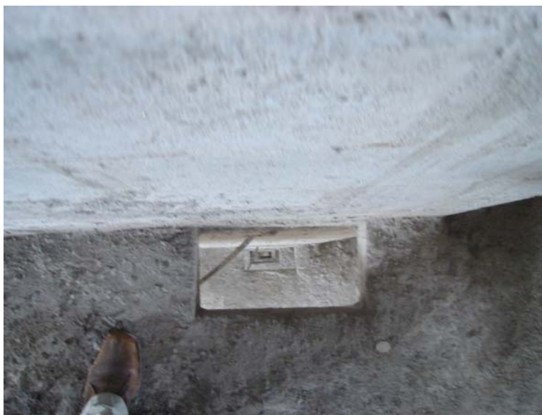
Figura 22: Detalhe do buraco formado na laje pela caixa de madeira.
