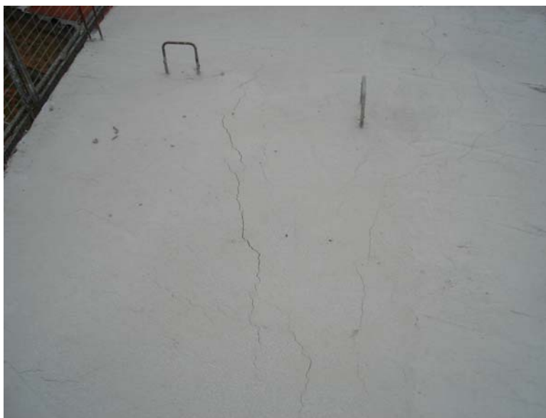
Figura 41: Algumas fissuras aparentes na laje.
