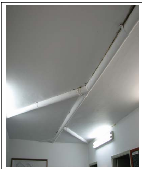
Fig. 03 - Infiltração na sala de administração
