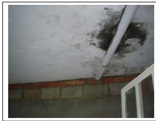
Fig. 02 - Infiltração devido falha na Impermeabilização
